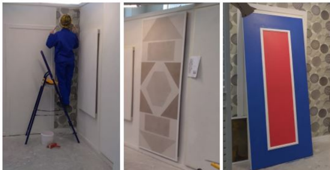
Рис. 4. Наклейка обоев, создание эскизов и трафаретов, окраска поверхности водоэмульсионными колерованными декоративными составами
